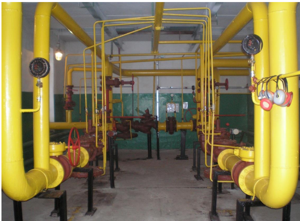
ГРП №1 ГОЛОВНОЕ до реконструкции
